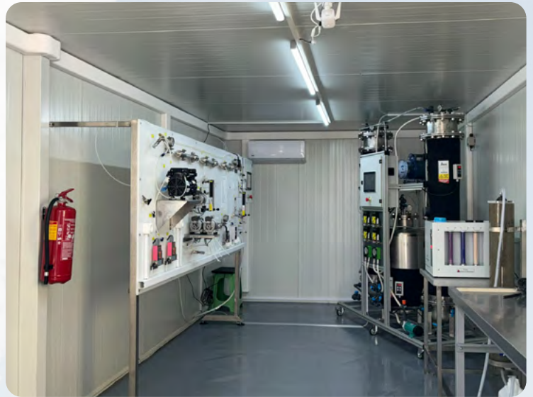
Εικόνα 1. Η κινητή μονάδα υβριδικής αποθήκευσης ενέργειας εγκαταστάθηκε στη μονάδα ηλεκτροπαραγωγής Αγίου Δημητρίου, δίπλα στη μονάδα αποθείωσης της πέμπτης καπνοδόχου του σταθμού.
